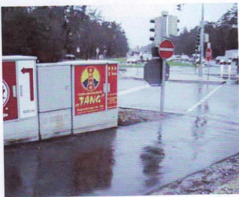
صناديق التوزيع الكهربائي
