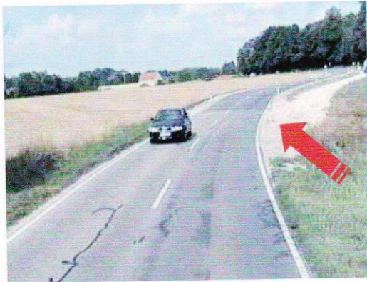
تضييق عرض الطريق وتراجع مفاجئ لمقاومة الانزلاق عند الطرف النهائي لأعمال الصيانة
